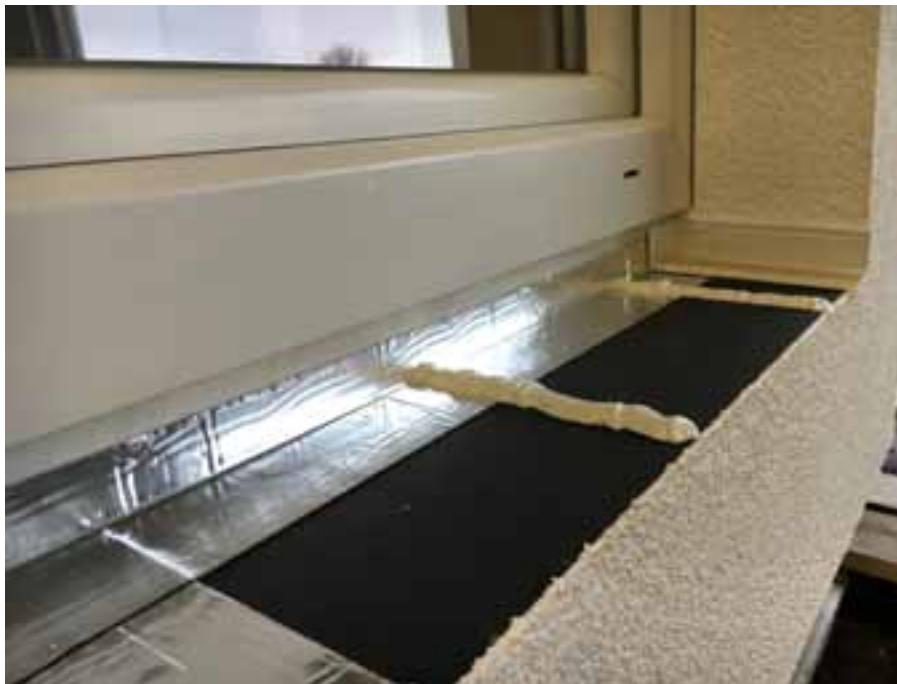
Abb. 4: So ist es richtig: Unter diesem Fenster wurde ein vorgefertigter Fensterbankkeil als zweite wasserführende Ebene montiert. Ein PVC-Slider ermöglicht den entkoppelten Einbau jeder Art von Fensterbank.
