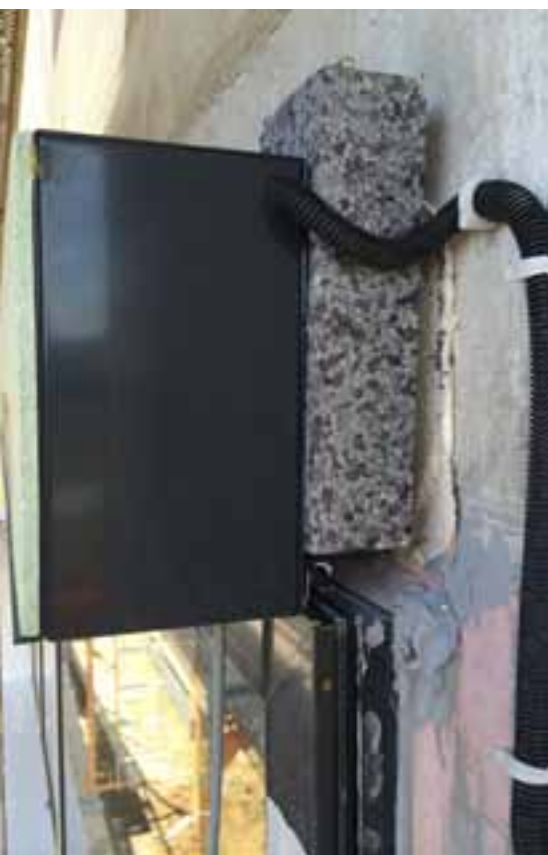
Abb. 2: Dieser Blechrollladenkasten mit XPS-Putzträger kann nicht sicher an ein WDVS angeschlossen werden. Eine Rahmenüberdämmung nach EnEV ist nicht möglich.
