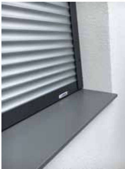
Abb. 8: Beispiel für ein fertig verputztes System: Die Fensterbank passt und die Rolladenführungsschienen sind entkoppelt.
