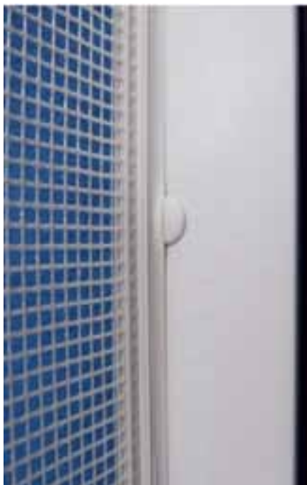
Abb. 3: Die Anputzleiste auf der bestehenden Rollladenführungsschiene wurde einfach über einen Befestigungspunkt geklebt. Das wird nicht lange dicht halten.
