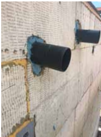
Abb. 9: Solche Flachdachentwässerungen durch ein WDVS kommen immer häufiger vor. Mit Dichtschäum sind diese Details nicht sicher an WDVS anzuschließen.
